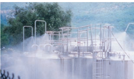
Installations brouillard d'eau
